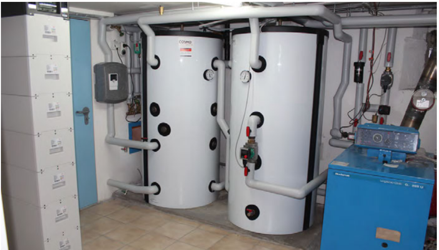
Das neue Heizsystem: Links der Turm mit den Batteriespeichern, in der Mitte 2 Warmwasserspeicher mit je 500 ltr. und rechts der bisherige Ölbrenner, der in das neue Heizsystem integriert wurde.
